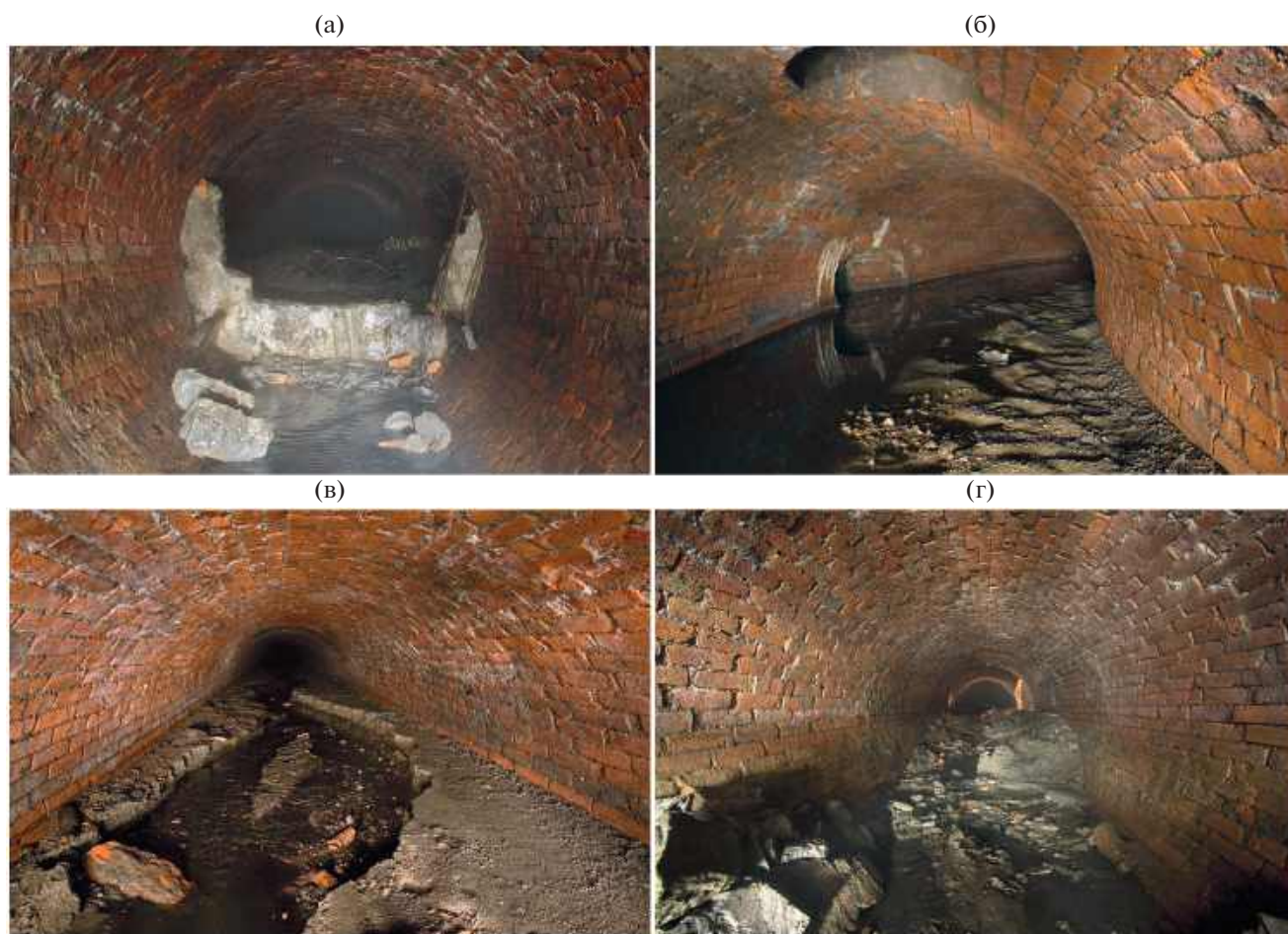
Рис. 2. Техноаллювиальная толща в коллекторе Калитниковского ручья в 2011 г.: бетонная перегородка во время демонтажа (а); техноаллювиальная толща в 265 м выше плотины (мощность на всем протяжении практически идентичная) в месте сужения коллектора (б); после демонтажа перегородки ручей начал стремительно врезаться в наносы (в, г). Фото С.А. Корнева и В.А. Неходцева.
